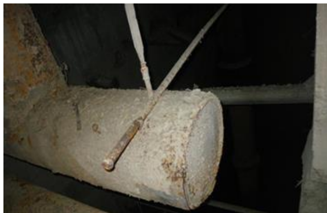
Figura 4.22. Conductă corodată interior stație SPA Dămieniști (2017) Figure 4.22. Corroded pipe inside Dămieniști SPA station (2017)
