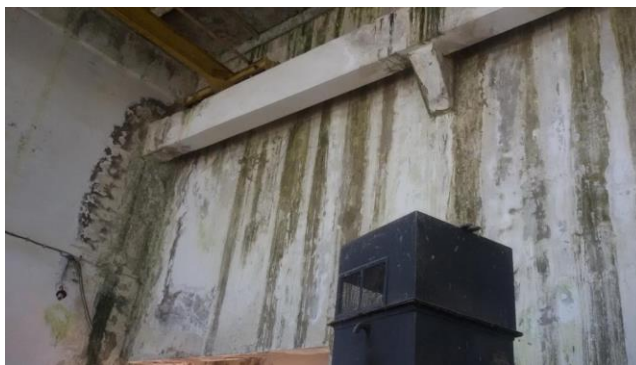
Figura 4.17. Pereți Stație de pompare – degradați (2017) Figure 4.17. Walls Pumping station – decay (2017)
